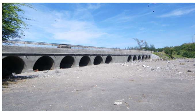
Situation avant cyclone
