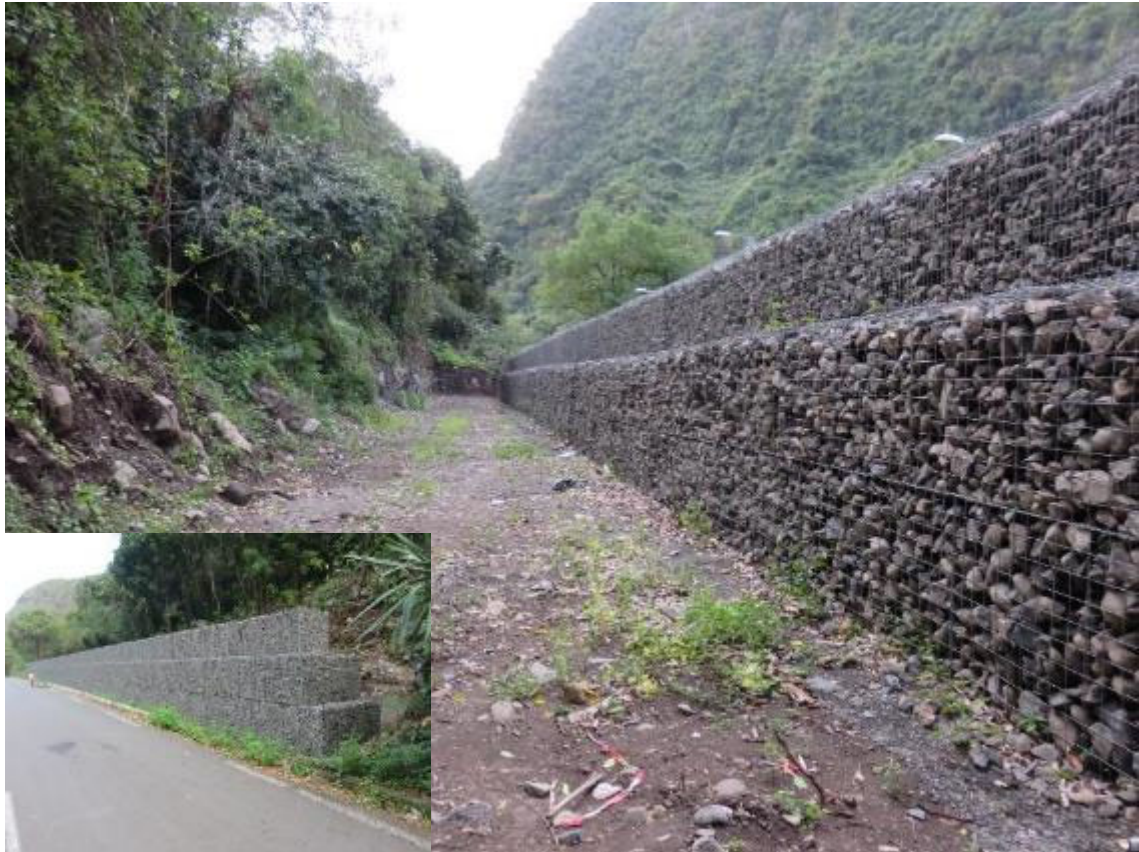
PHOTOGRAPHIE 19 : PIÈGE À BLOCS (MUR EN GABIONS ET FOSSE) CONSTRUIT EN AMONT DES HABITATIONS D'ÎLET ROND
